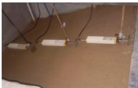
图 14 路基安装的位移传感器
